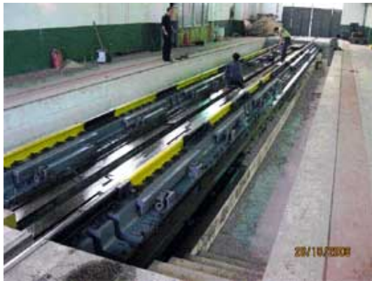
图2 现场安装中的称重台主体部分
