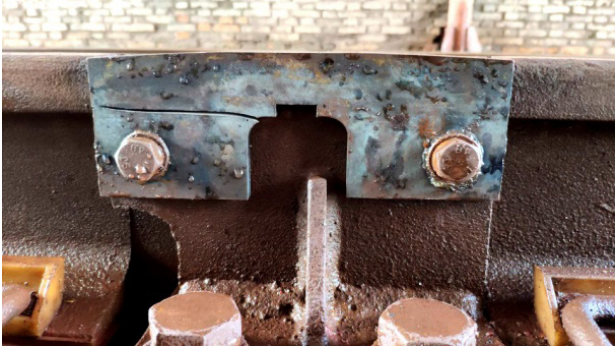
图3 轨道衡过渡器损坏故障图
