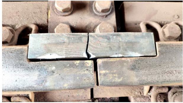
图4 轨道衡过渡器损坏故障图
